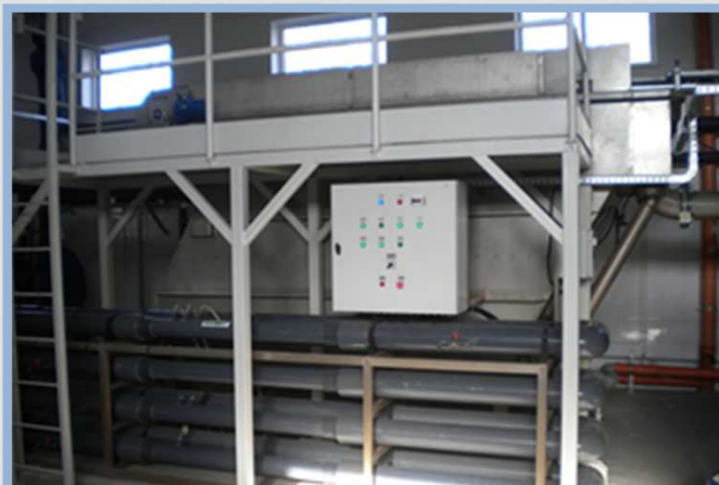
Stacja flotacji ciśnieniowej
